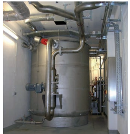
Cuve de stockage des déchets organiques.
