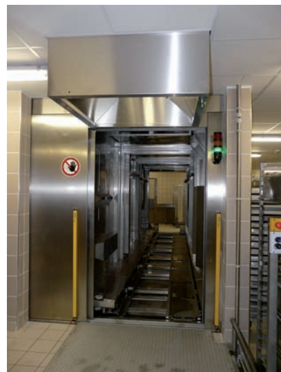
Tunnel de lavage des chariots de l'hôpital de Plaisir.
